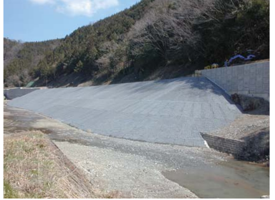
（押さえ盛り土保護工） [国土交通省江の川総合開発工事事務所]
